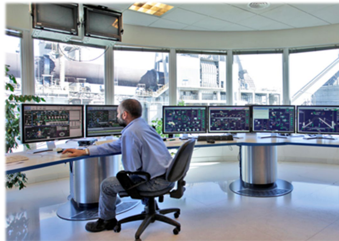
L´Amalí: Control room
