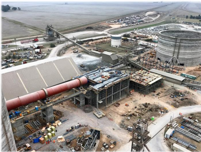
L'Amalí 2: Kiln & Clinker Silo
