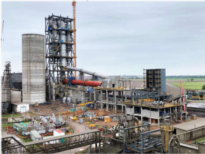
L'Amalí 2: Kiln & Clinker Silo
